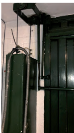
Contrapeso sin protección
